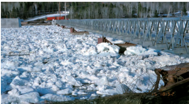
写真- 2.2.4.4 橋脚周辺のアイスジャム
