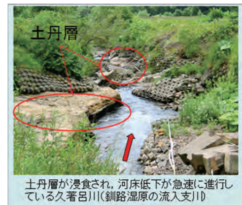
写真 - 2.2.4.5 土丹の侵食状況 (久著呂川)
