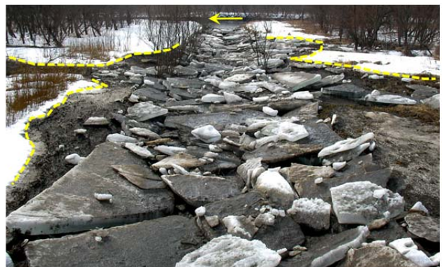
写真-6 浦幌十勝川 U 3 樋門における氷板痕跡 (KP.4.20 L)
