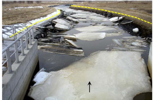
写真-8 新釧路川 K 2 樋門 (KP. 4.50 L) における氷板痕跡
