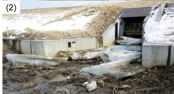
写真-2 十勝川 T 1 樋門における氷板痕跡 (KP. 3. 30 R)
