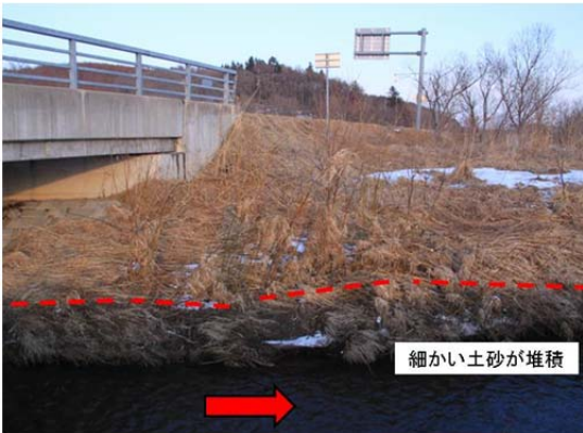
写真-15 ワッカリベツ川土砂堆積状況 (土砂中の塩化物イオンは 0.0039% Cl - )
