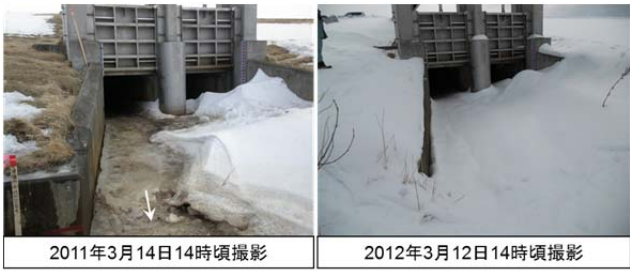
写真-2 十勝川 KP.4.0 地点 T 1 樋門ゲート
