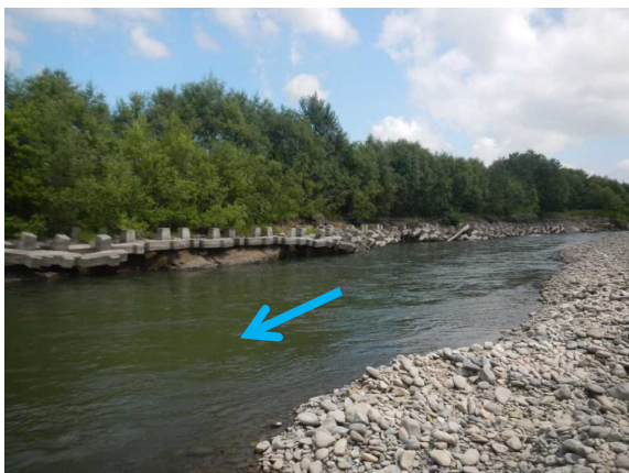
図 1.7 浮き上がった状態の低水路護岸
