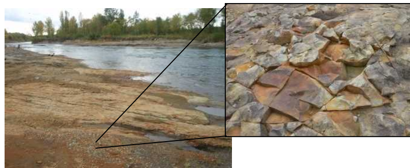
図 1.13 乾湿繰返しにより表層が劣化した岩盤 (石狩川)
