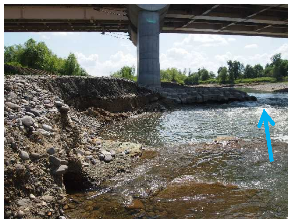
図 1.9 橋脚付近における急激な河床低下
