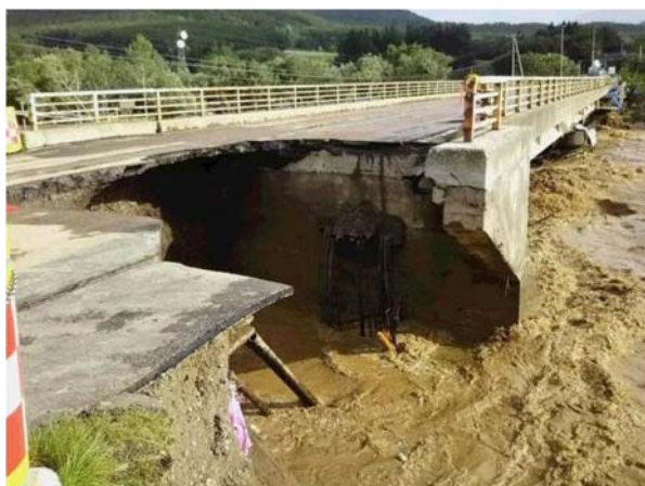
写真 1.4 太平橋左岸橋台背後の洗掘
