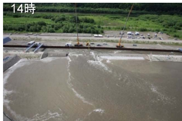
14時 ブロックの上流部が一部流出
