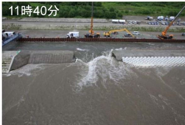
11時40分 決壊幅約 16m 決壊幅がさらに広がりブロック上流端付近まで到達
