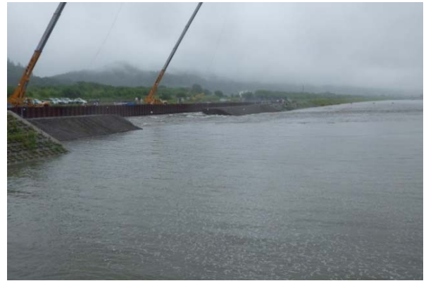
再度破堤が進行
