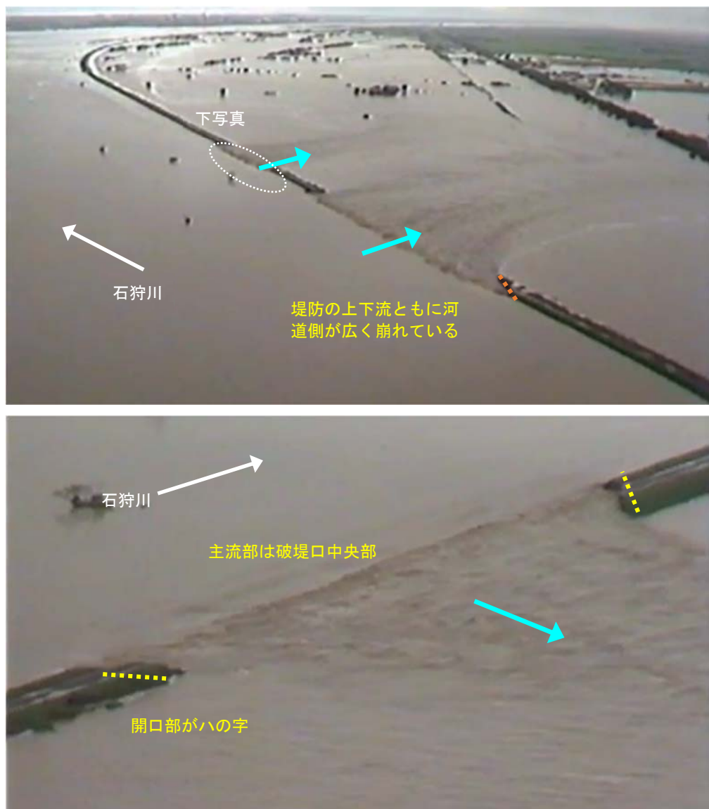
写真 2.2 石狩川の堤防決壊状況
