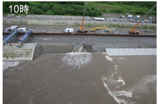
10時 決壊幅約 5m 決壊幅が下流側に広がる
